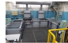
中型槽試験開発設備
